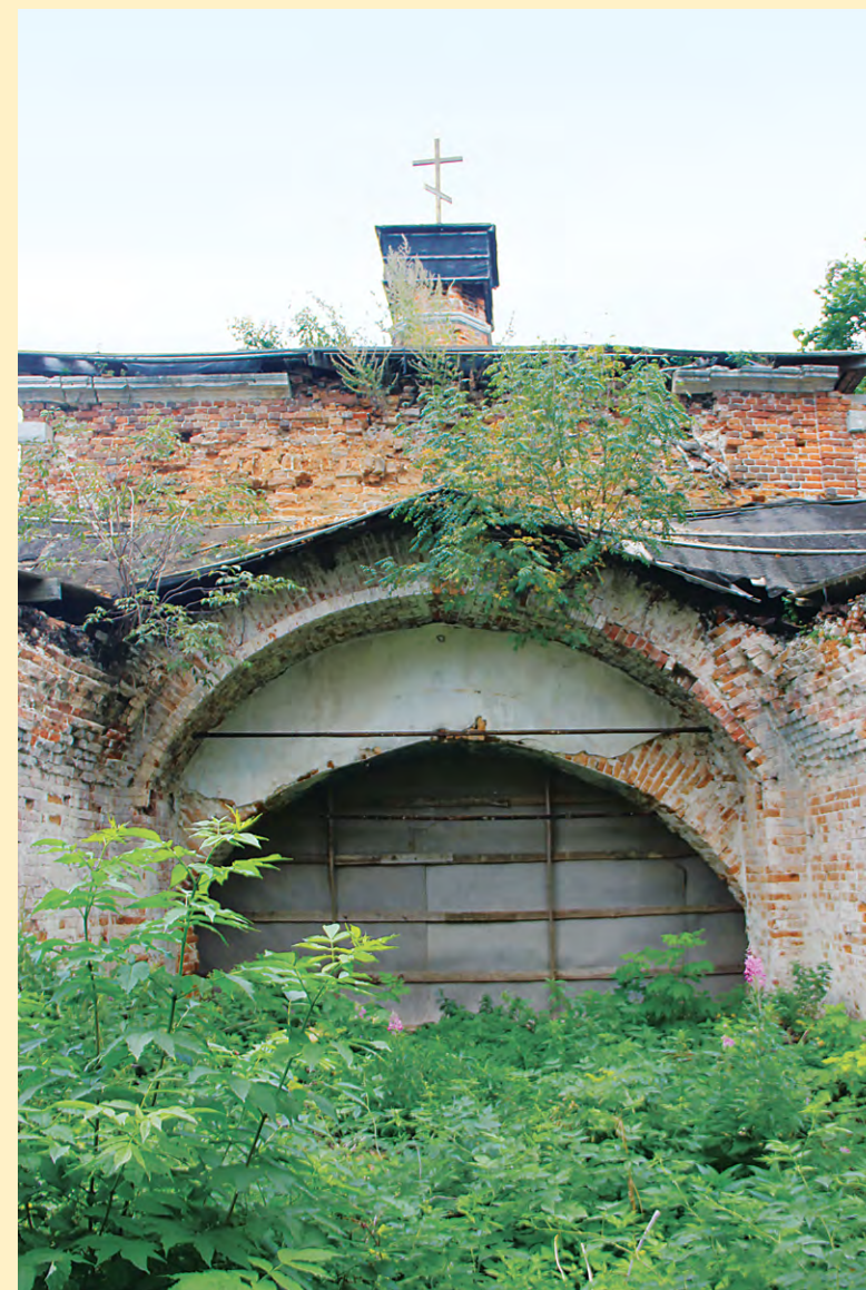
Обрушенный свод трапезной храма. Фото 2015 года
