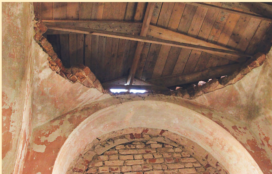
Своды колокольни разрушены и перекрыты временной кровлей
