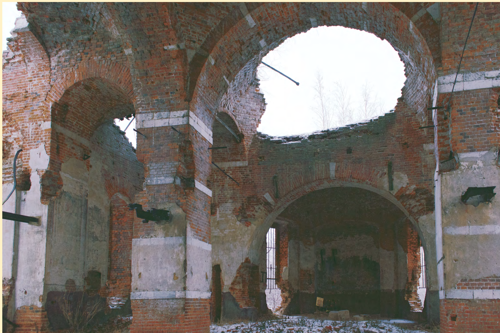
Обрушенные своды в Богородицерождественском храме. Фото 2015 года
