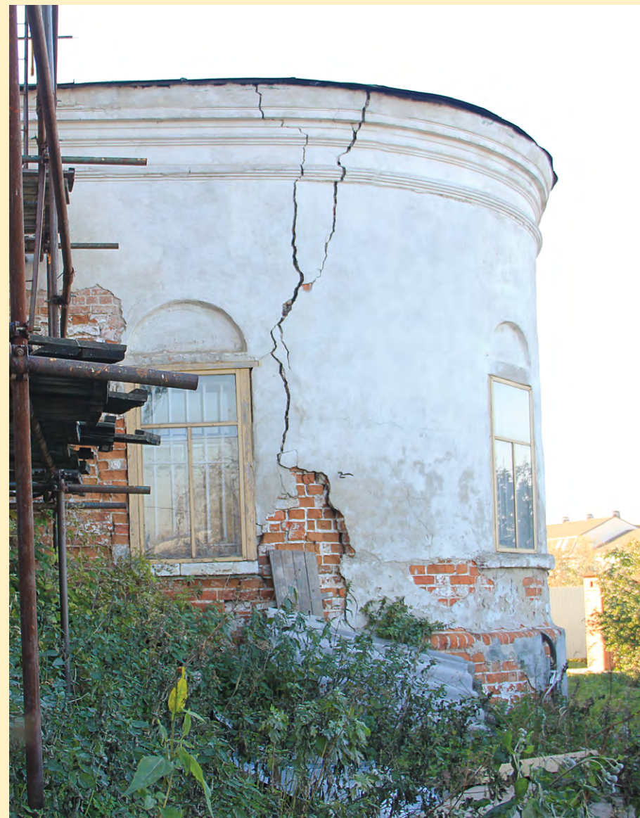
Трещины в стенах Никитского храма. Фото 2015 года
